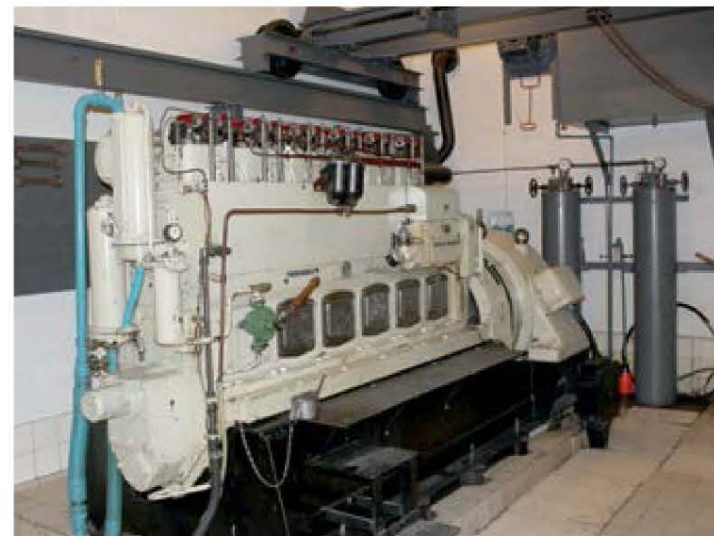
Основной дизель-генератор, установленный в бункере
